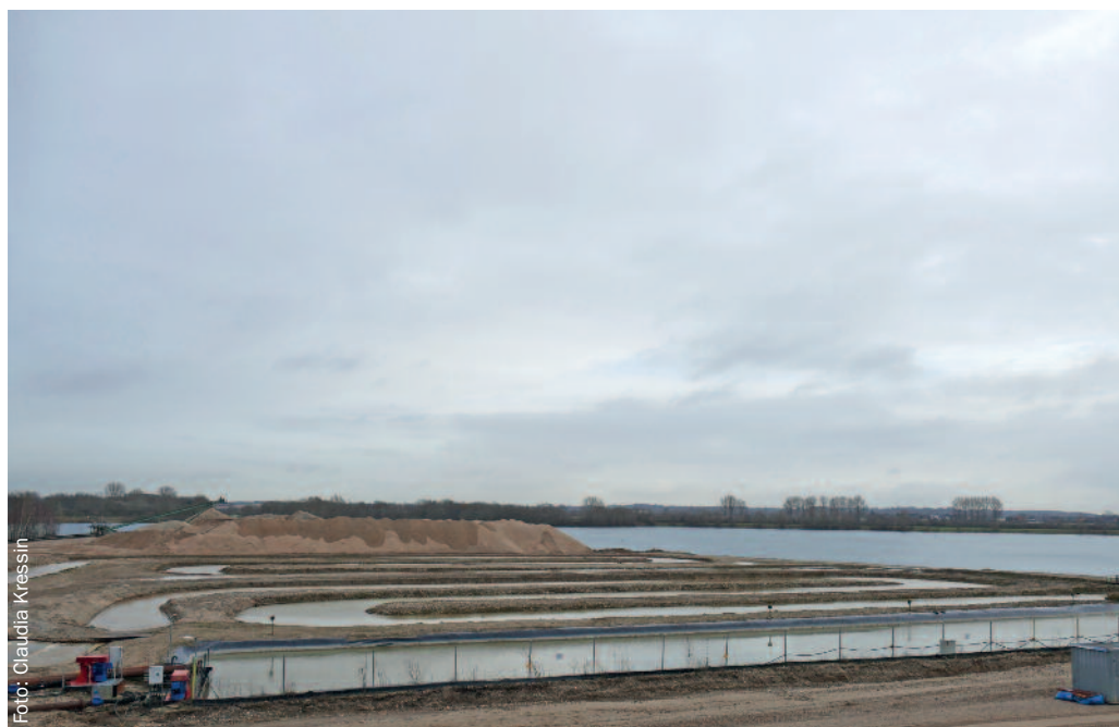
Wasserrecycling-Anlage bei Holemans in Ellerdonk bei Wesel
